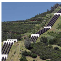
供水/输水管道
